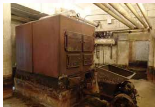
滋賀の豊郷小学校の地下室に残るアサヒボイラー5型。戦時供出等で現存する個体は極めて少ない。自動給炭器が付いている。（撮影協力：豊郷町教育委員会）
